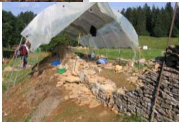
👉 Pause du matin, le chantier est déserté. A remarquer l'espace très limité côté talus pour travailler
