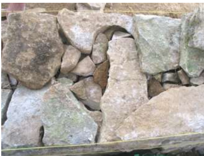
➡ Détail d'une astuce de montage : une demi boutisse s'imbrique dans l'arc d'une pierre de parement.
